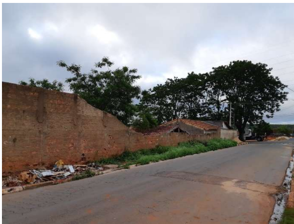
Figura 4: Muro a ser recuperado
