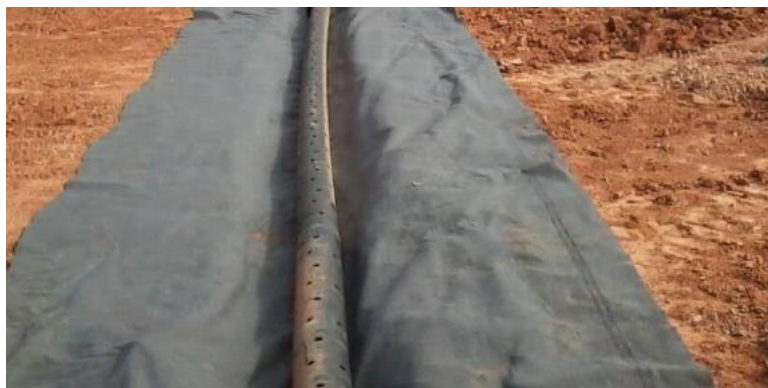
Figura 2: Foto demonstrativo: Vala do sistema de drenagem de chorume, já aberta, envolta com a manta geotextil não tecido, e com o tubo de PEAD perfurado em seu interior.
