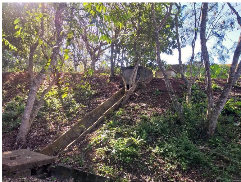
Figura 1: Drenagem de águas pluviais no Aterro Sanitário de Capão Bonito.
