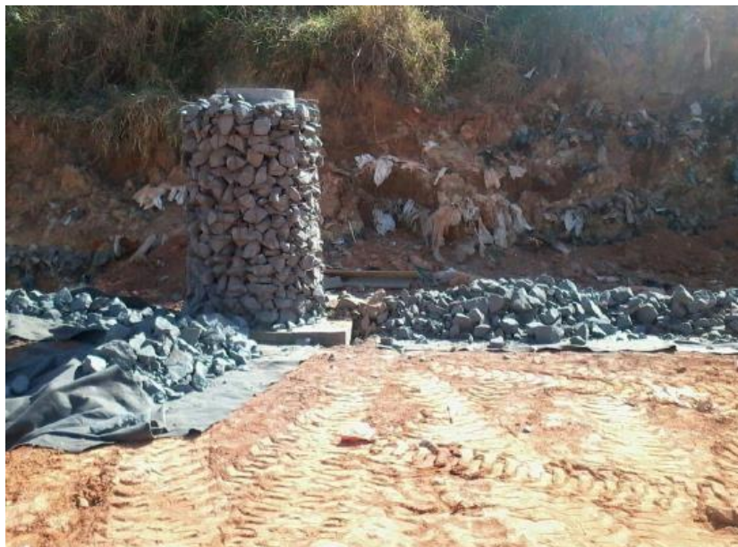
Figura 9: Foto demonstrativo: Sistema de biogás já devidamente pronto sobre a caixa de passagem do sistema de drenagem de chorume.
