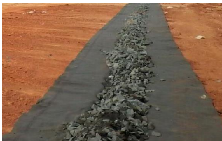
Figura 3: Foto demonstrativo: Sistema de drenagem de chorume já devidamente preenchido com abrita 04.
